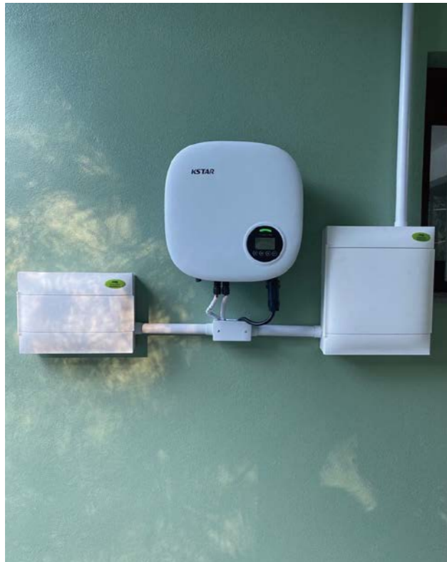
05 Wohn-Solarenergieprojekt in Brasilien
