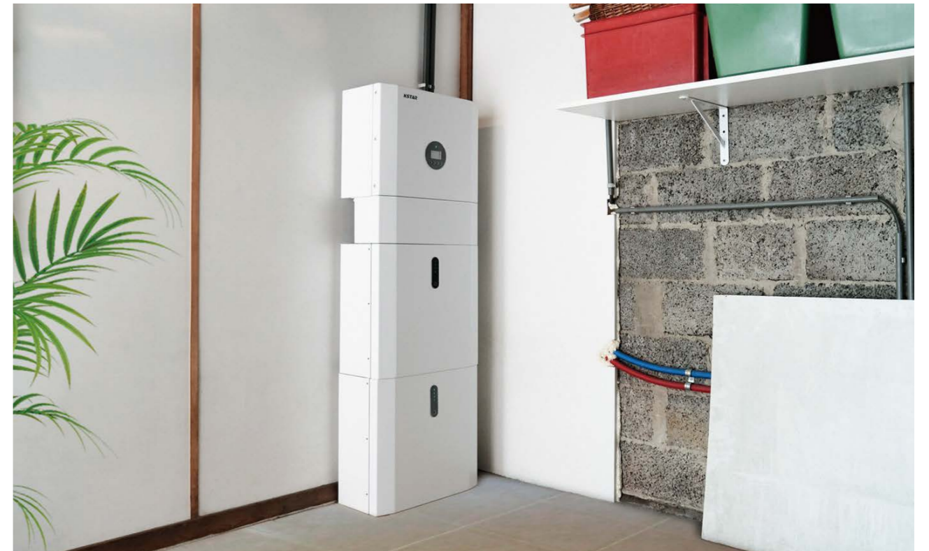
07 Wohn-Energiespeichersystem in den Niederlanden
