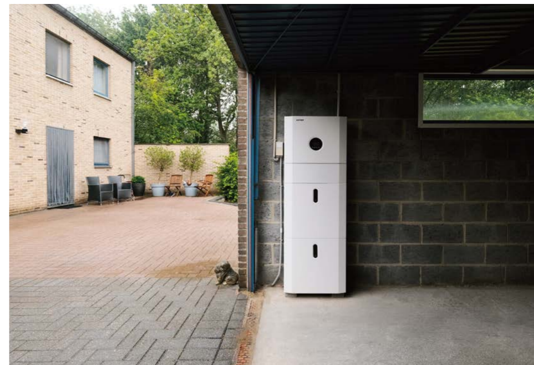
04 Wohn-Energiespeichersystem in Belgien
