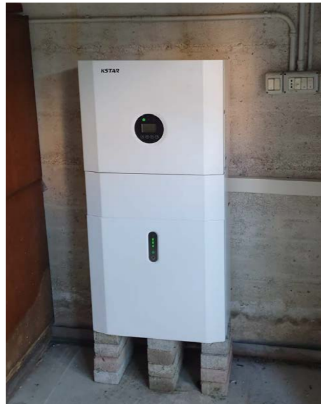
06 Wohn-Energiespeichersystem in Italien
