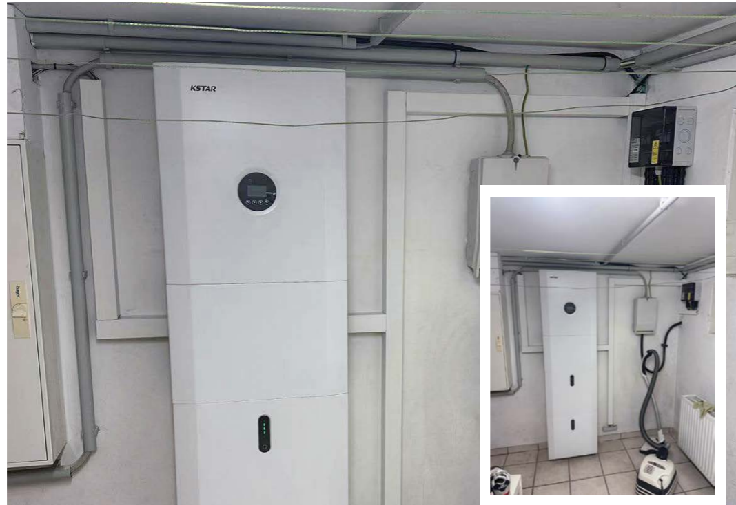
01 Wohn-Energiespeichersystem in Deutschland
