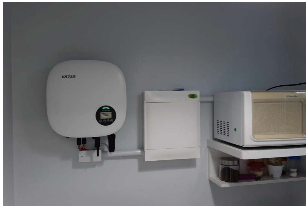
03 Wohn-Solarenergieprojekt in Brasilien
