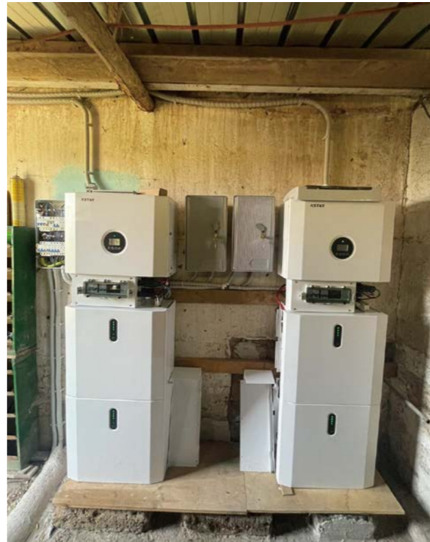
09 Wohn-Energiespeichersystem in Italien
