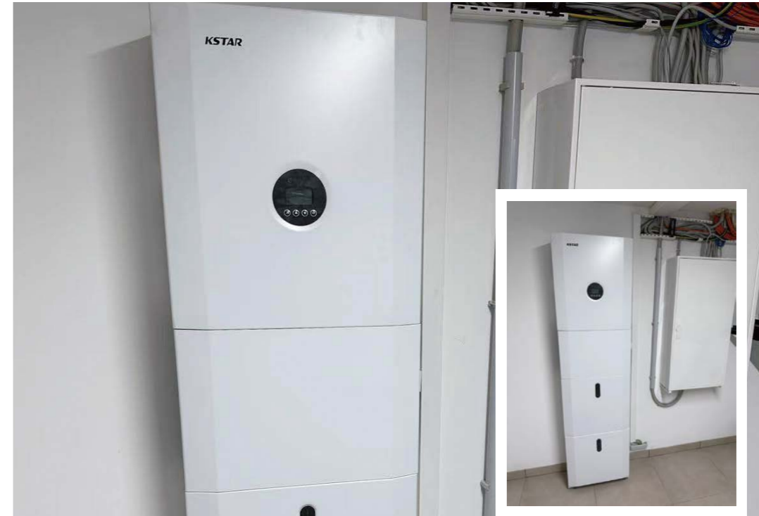
02 Wohn-Energiespeichersystem in Deutschland
